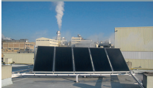
Pilotprojekte: In Spanien haben wir an unseren Produktionsstandorten in Sevilla und in Montornès (im Bild) kleinere Solarthermie-Anlagen installiert. Diese Anlagen nutzen die Wärme aus Sonneneinstrahlung zur Bereitstellung von Warmwasser an den Standorten.
